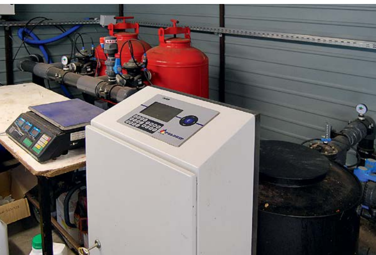
Fot. 4. Za podawanie wody i nawozów odpowiada mikser nawozowy zainstalowany przez firmę Poldrip
